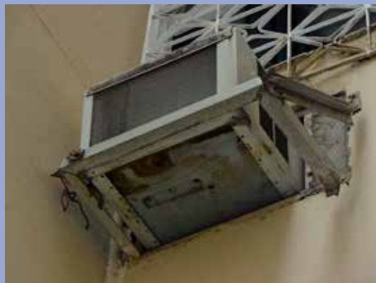
Instalação irregular de aparelho de ar condicionado
