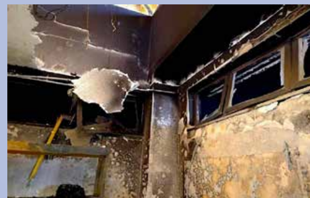
Aquecimento em aparelho de ar condicionado causou incêndio em hospital de Aracaju (SE) em 2021
